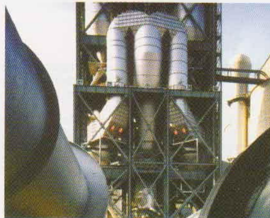
VSR BLASTER® Luftkanonen an einem Zementofen (Foto: Krupp Polysius)
