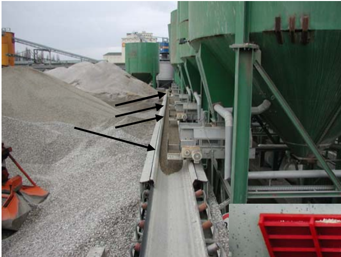
Stortschotten bij beton- en asfaltinstallaties.
